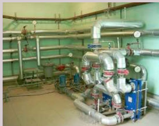
Центральный тепловой пункт аппарата управления ГУП «ГУ НИ СПб»
