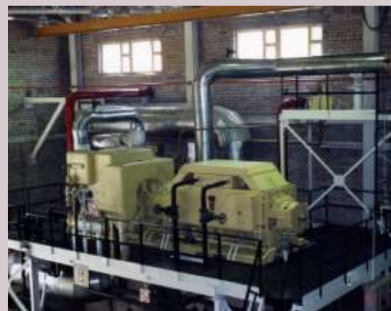
Мини-ТЭЦ, ОАО «ВОМЗ» мощностью 3,5 МВт г. Вологда
