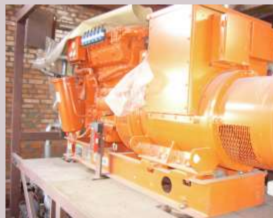
Газопоршневой энергоисточник Банковского центра по ул. Бабушкина, СПб
